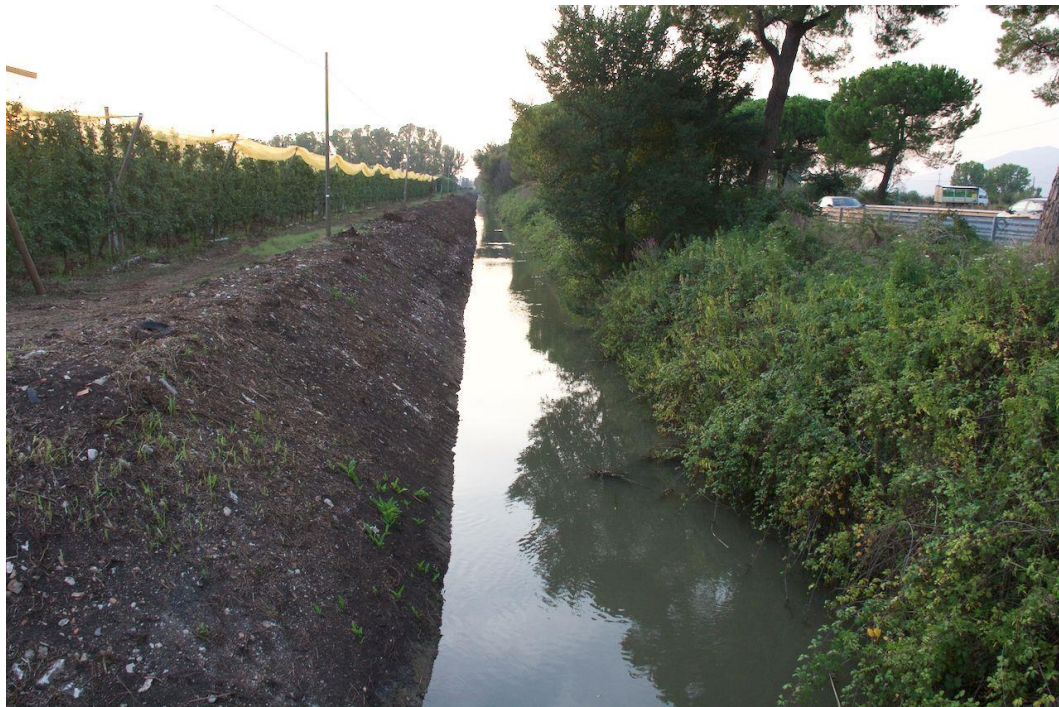
Figura 7 Esempio di intervento di manutenzione dei canali con eliminazione totale della vegetazione ripariale lungo il Canale Linea Pio, controindicato in quanto nocivo per la biodiversità (Foto: Giovanni Mastrobuoni)
